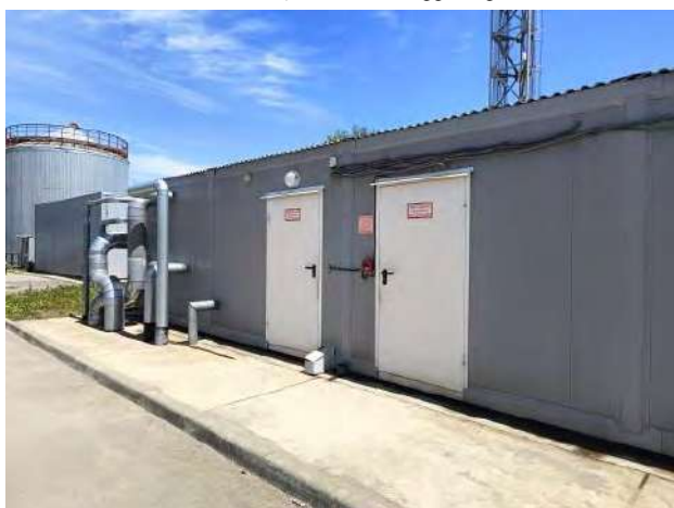
Фото № 9. Котельная (Блочно-модульная котельная БМК ЕСО-2150-Д)
