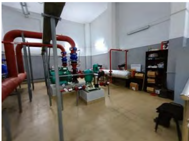
Фото № 23. Насосная станция наружного пожаротушения (НСПТ)
