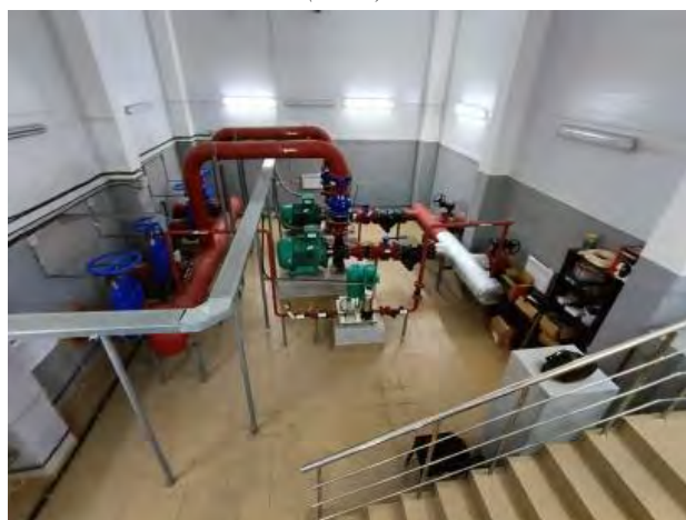
Фото № 22. Насосная станция наружного пожаротушения (НСПТ)
