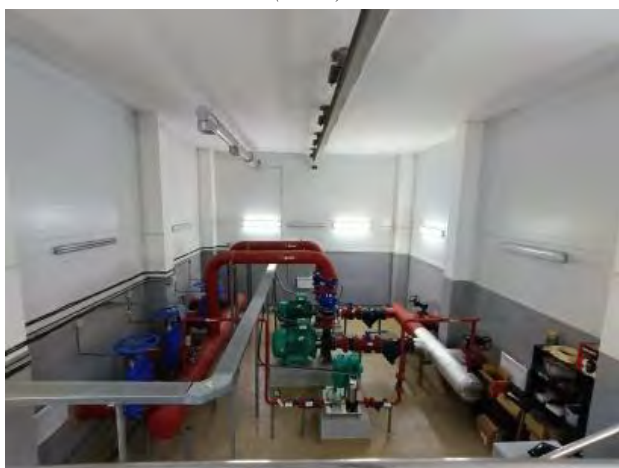
Фото № 21. Насосная станция наружного пожаротушения (НСПТ)
