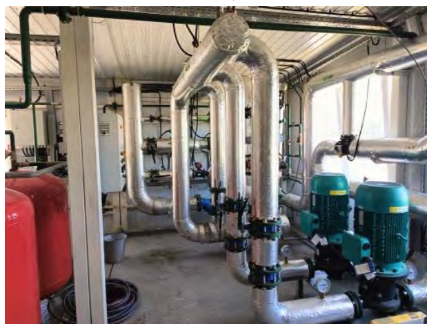
Фото № 14. Котельная (Блочно-модульная котельная БМК ECO-2150-Д)
