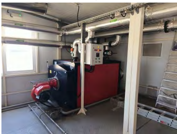
Фото № 13. Котельная (Блочно-модульная котельная БМК ECO-2150-Д)
