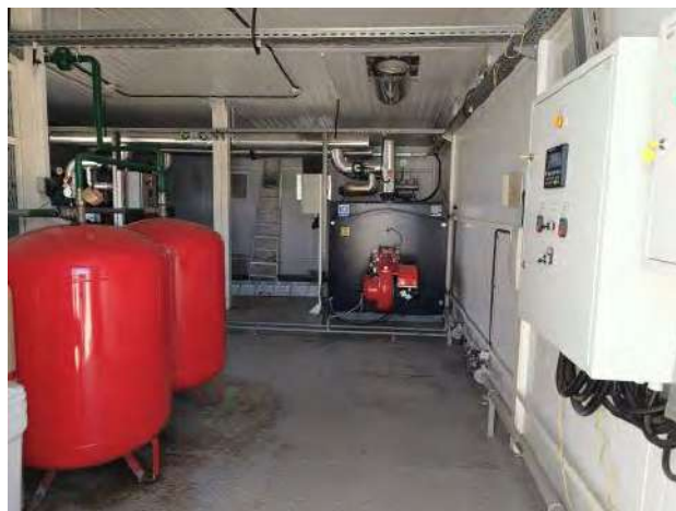
Фото № 12. Котельная (Блочно-модульная котельная БМК ECO-2150-Д)
