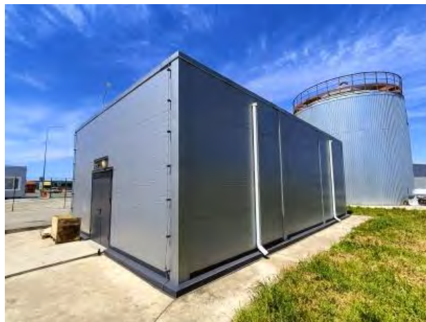
Фото № 18. Насосная станция наружного пожаротушения (НСПТ)
