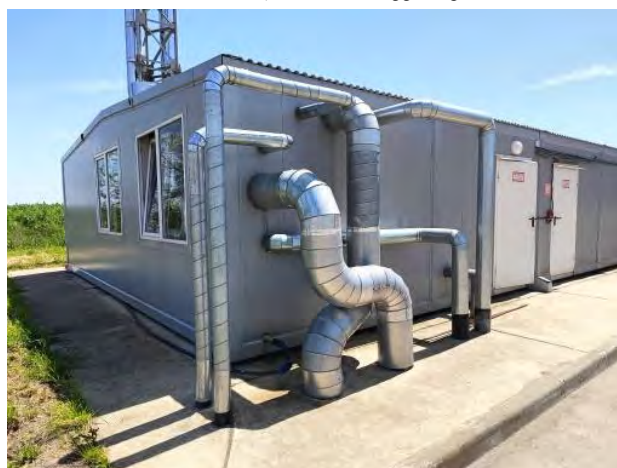
Фото № 10. Котельная (Блочно-модульная котельная БМК ЕСО-2150-Д)
