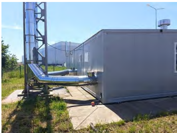
Фото № 11. Котельная (Блочно-модульная котельная БМК ECO-2150-Д)
